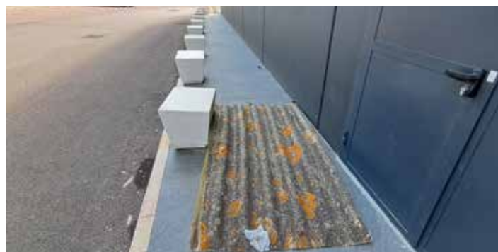
Dietro il Centro Commerciale di Piazza Pirandello, lastra di eternit abbandonata, situazione al 28 agosto
