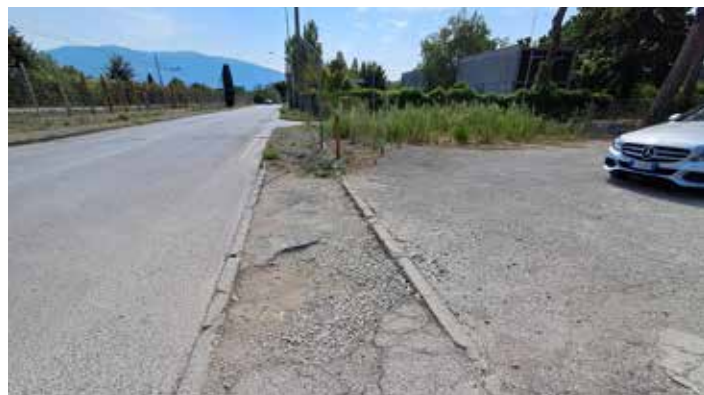
Via Zoilo Santovecchi, buca eterna sul marciapiedi
