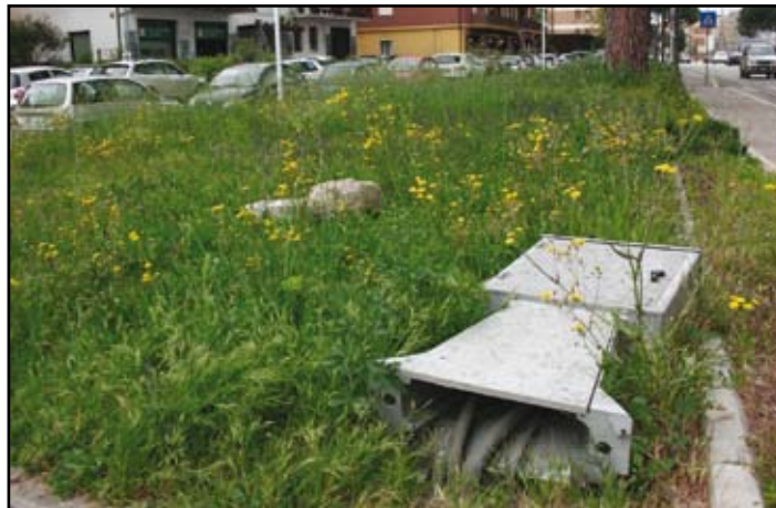
Via Los Angeles, la centralina è "dormiente" da alcuni mesi
